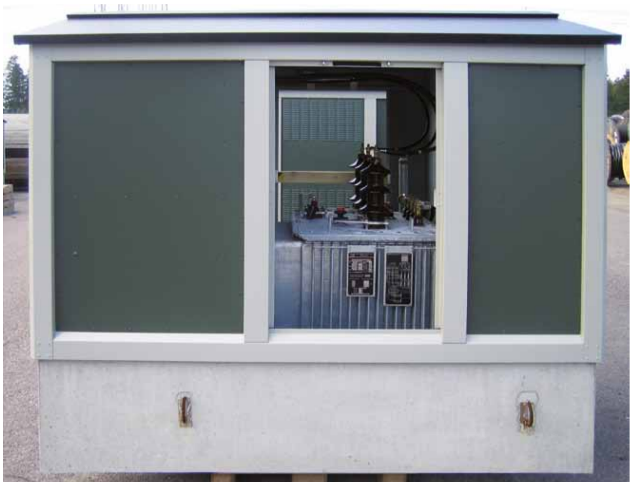
ТРН 50-20,5 постављен у киоск на складишту Jämtkraft AB непосредно пре монтаже на средњенапонску мрежу
