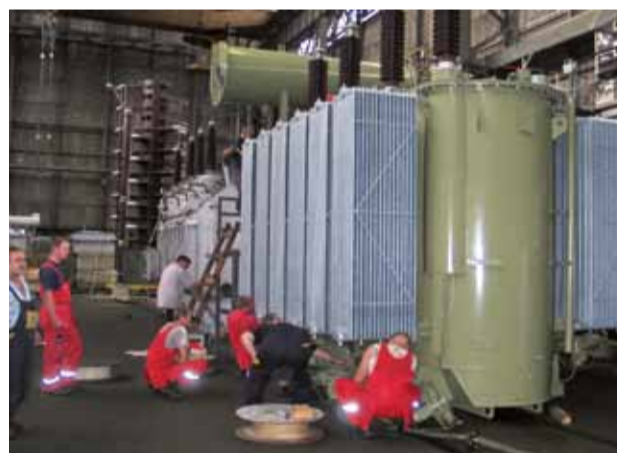
Енергетски трансформатор снаге 40 MVA
